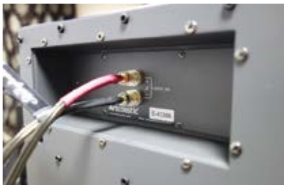
Терминалы акустического кабеля размещены в углублении
